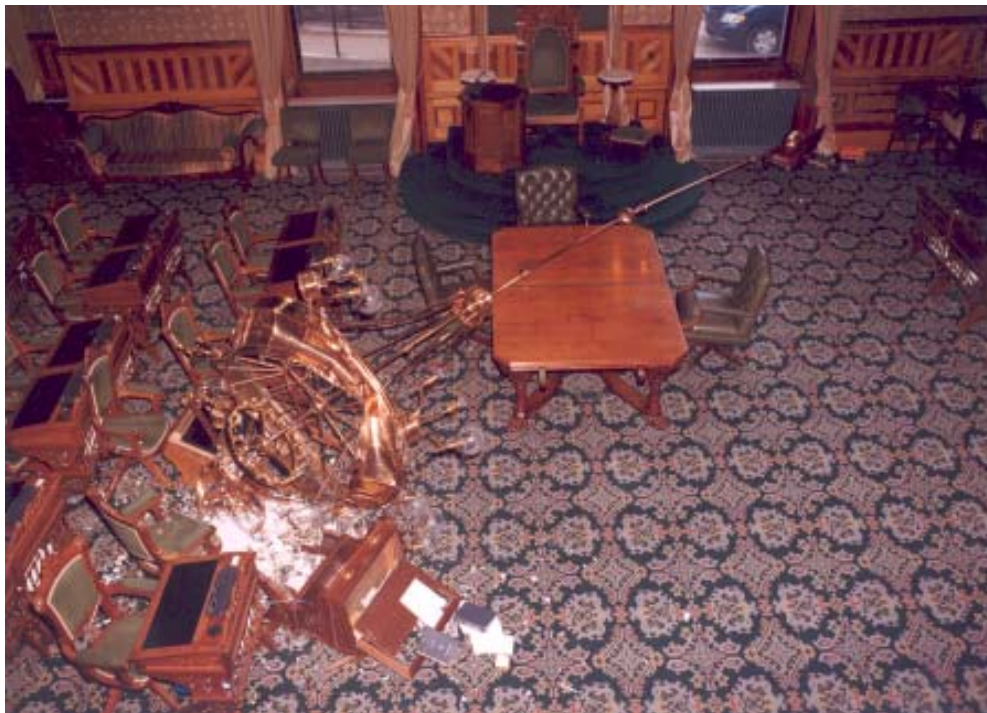
Le 8 novembre, presque un an après la fin des travaux de restauration et plusieurs jours avant le début des travaux de l'Assemblée législative, le lustre du côté sud s'écrase au sol pendant qu'il est monté, après avoir été descendu pour être nettoyé. Les dommages les plus importants sont à l'armature du lustre orné en laiton rose et à la majorité des 574 morceaux de cristal Waterford suspendus à l'armature, y compris plusieurs des 18 globes en cristal au plomb du lustre. Des luminaires temporaires sont installés et demeureront en place jusqu'à la restauration complète du lustre du côté sud.
